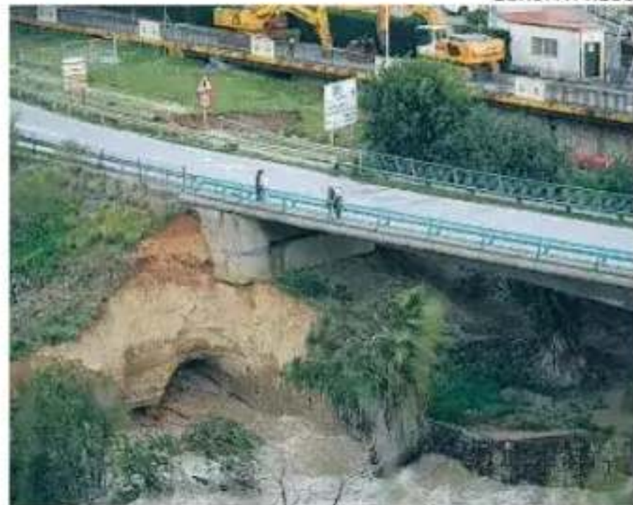
Desprendimiento en Arcos de la Frontera (Cádiz)
